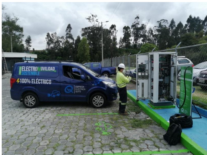
Figura 4. Mantenimiento electrolinera Sangolquí
